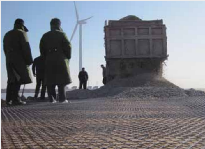
TriAx stabiliseringsgeonett er brukt til å lage et mekanisk stabilisert lag i byggingen av en adkomstvei i Dongying Vindpark, i Kina.
