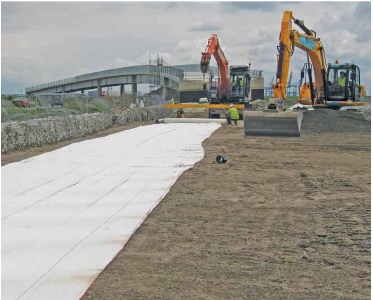
Installasjon av Basetex som en oppspent membran over borede peler på A228 motorveifylling i Kent.
