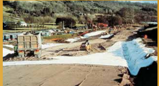
Ved Garrion Bridge, Scotland ble Basetex redningen for å unngå kostbar forsterkning av grunnen over gruveganger.
