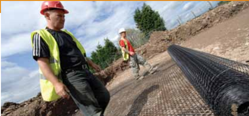
TriAx installasjon, Stoke
