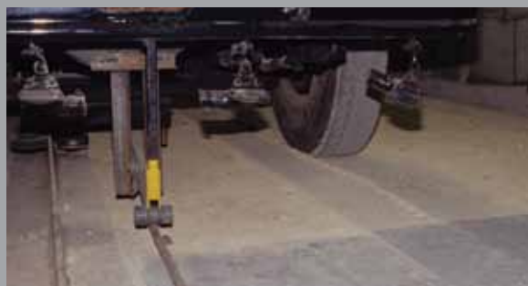
1996 – Fastlåsningsfunksjonen til Tensar geonett og reduksjon av sideveis bevegelse av steinmaterialer fører til betydelig reduksjon av hjulspor.
